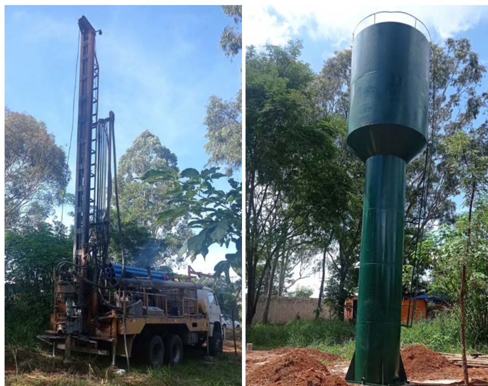
Poço artesiano e caixa d'água para a irrigação das áreas em recuperação ambiental na época da seca
