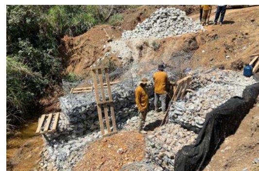
Dissipador de gabião do reservatório 2
