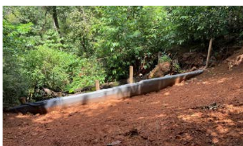
Erosão 6 recuperada e revegetada
